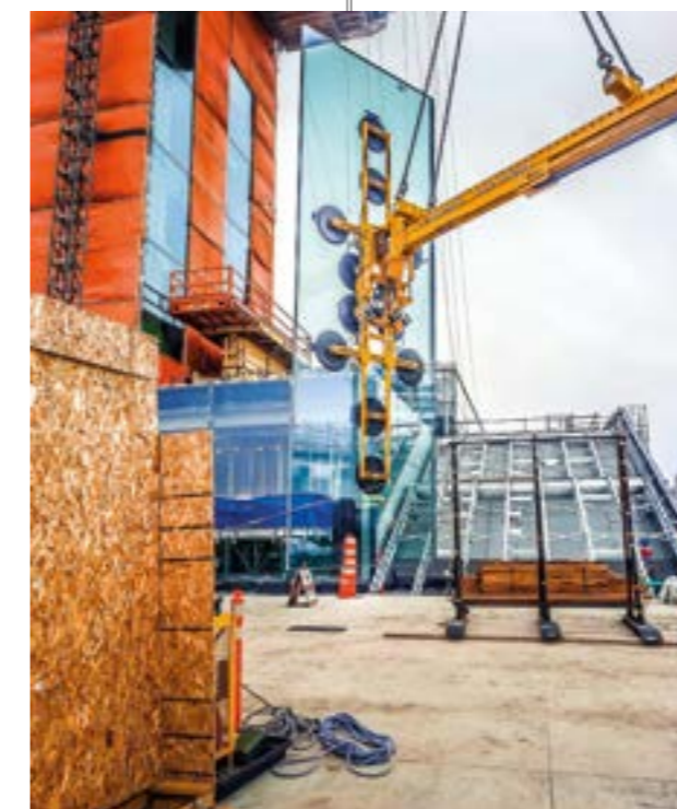
Montarea la o înălțime de 60 de metri cu VSG 3000 KMH și VSG 2000 Konter
