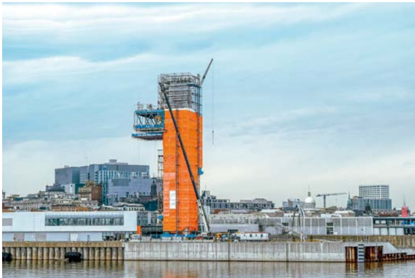
Montarea panourilor Heavydrive la Tour du Grand Quai din Montréal QC (Canada)
