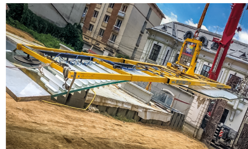
Instalația Heavydrive transportă sticla turnată în formă ondulată de 12,5 metri înălțime. Drepturi de autor imagine: montec-gmbh.de
